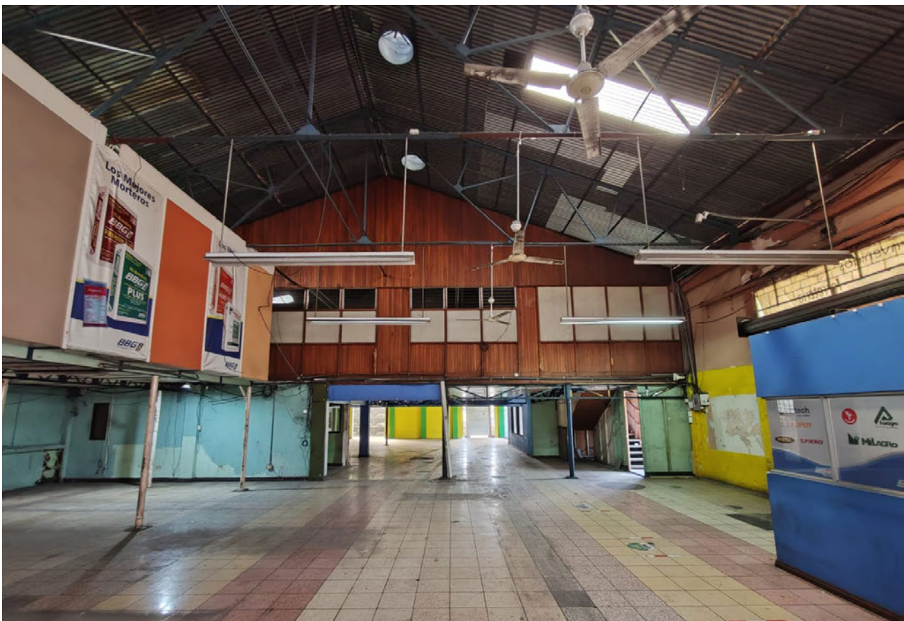
Fotografía del interior de la nave principal, se observa al fondo las antiguas aulas del INA construidas por el anterior inquilino, las cuales dejaron de funcionar hace varios años. Hechas con madera sobre estructura metálica, la altura del piso del primer nivel al entepiso de las aulas es muy bajo, menos de 2,40m
