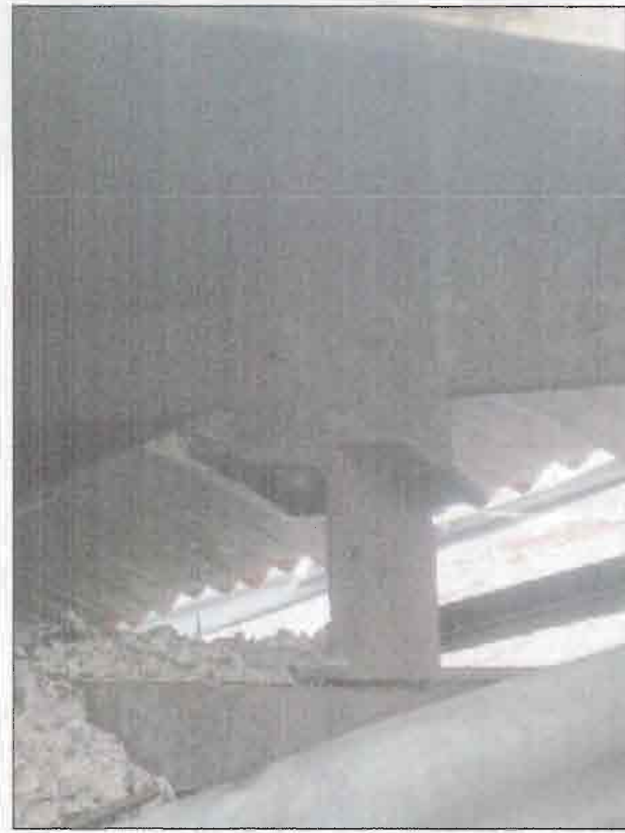
DETALLE DE JUNTA DE ESQUINA DE CERCHA DEL TORRION CON LA PARED, SECCIONES METALICAS ATORNILLANDO LAS CERCHAS AL CONCRETO
