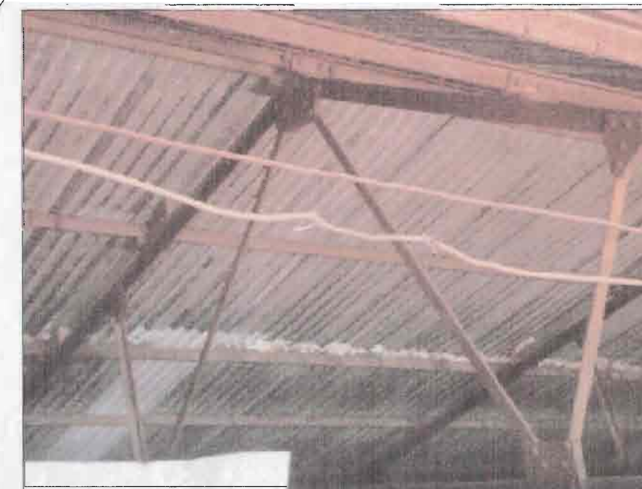
DETALLE TIPICO DE CERCHA DE TECHOS, CON UN GRADO DE DETERIORO BAJO, SE RECOMIENDA UNA RESTAURACION LEVE
