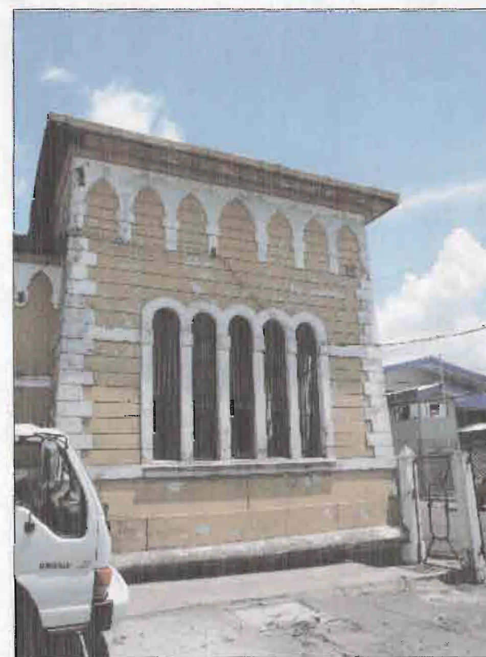
VENTANA ORIGINAL, ELABORADA EN CONCRETO CON REJILLA METALICA, CON BORDE SUPERIOR EN FORMA CIRCULAR, CON UN NIVEL DE DETERIORO BAJO, SE RECOMIENDA UNA RESTAURACION LEVE
