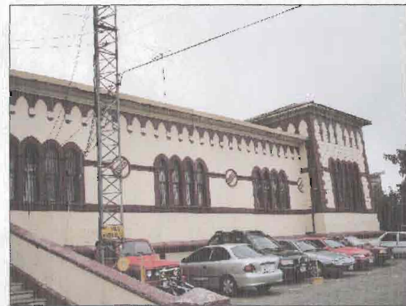
VENTANA ORIGINAL, ELABORADA EN CONCRETO CON REJILLA METALICA Y BORDE SUPERIOR EN FORMA DE PICO, TIENE UN NIVEL DE DETERIORO BAJO, SE RECOMIENDA UNA RESTAURACION LEVE
