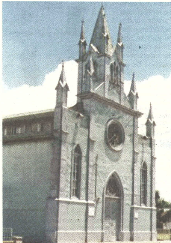
El Arq. Carlos Araya Aguilar, ganador del certamen explicó que los primeros trabajos que se realizarán son reestructurar las torres que presentan un desplome en su parte superior, y hacer trabajos en la cubierta del techo.
