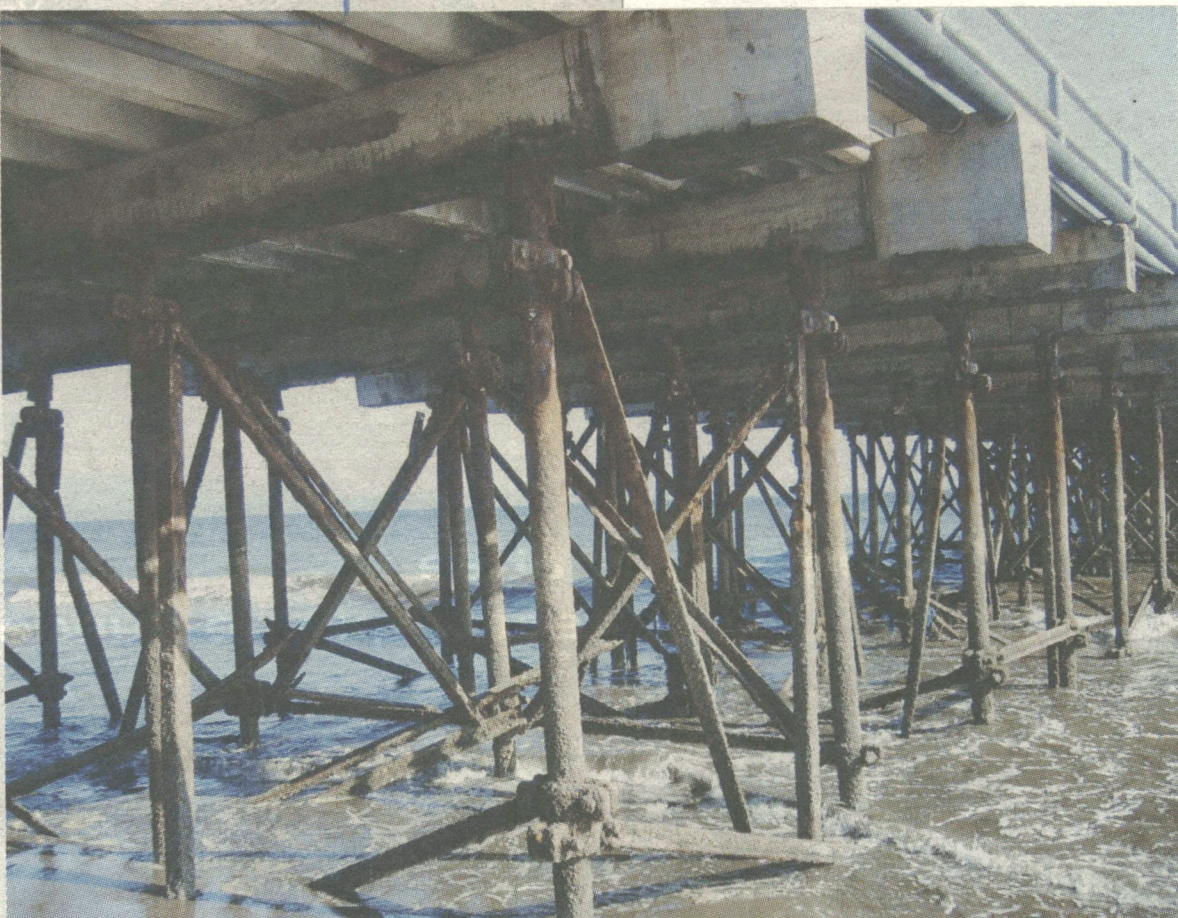
Este tramo del muelle de cruceros está muy deteriorado. Varios soportes de acero cayeron. RONNY SOTO PARA LN
