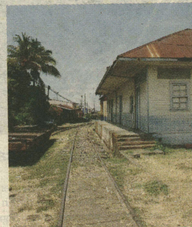
La estación ferroviaria está deteriorada. ANDRÉS ZÁRATE PARA LA NACIÓN
