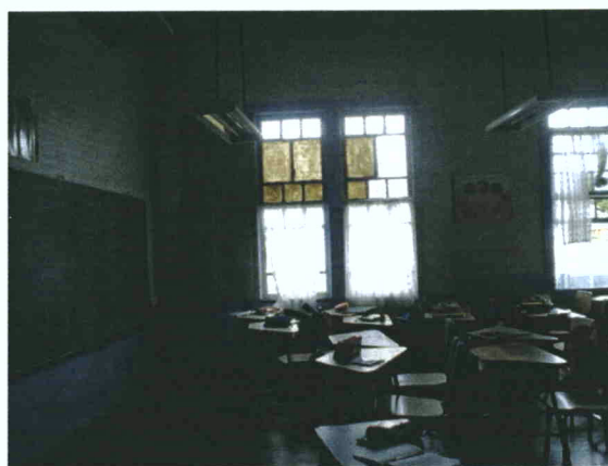
Aulas con problemas de iluminación Natural
